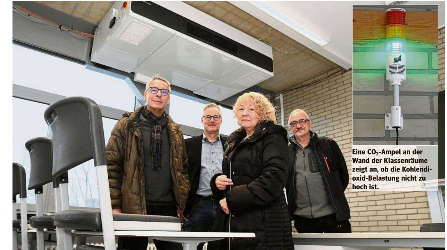
Zogen am ersten Ferientag eine durchweg positive Bilanz: Heiner Steingreifer (v. li.) vom Kommunalen Immobilienmanagement, Schulleiter Tobias Hommel, Ingrid Knaup und Norbert Lowin (Die Grünen) in einem Klassenraum mit Lüftungsanlage unter der Decke.
